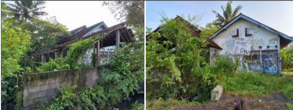
Gambar 7. Pemanfaatan Lingkungan Tata Ruang dan Lahan Tanah yang Kurang Baik
